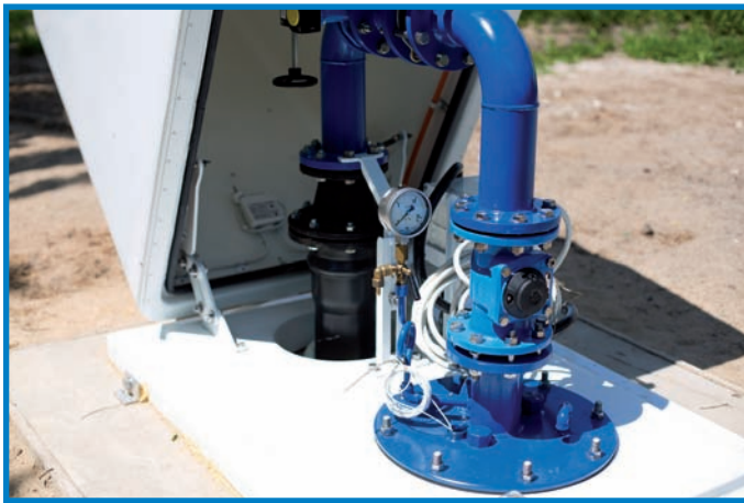
Stacja uzdatniania wody została zmodernizowana dzięki wsparciu z zewnątrz.
