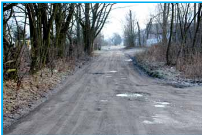
Obecny stan drogi w miejscowości Studzienice
