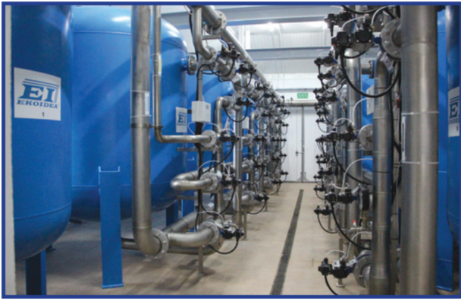
Pozyskane w przeciągu mijającej kadencji dofinansowanie w kwocie ponad 43 milionów złotych zaowocowało przeprowadzeniem przez samorząd znaczących inwestycji, tu zmodernizowana stacja uzdatniania wody w Glinicach..
