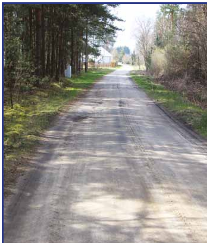
Jagodno. Obecny stan drogi do miejscowości Jagodno.
