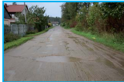
Fatalny stan drogi przed modernizacją
