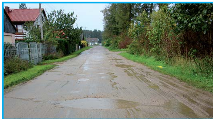
Obecny fatalny stan drogi.
